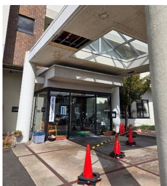
〈いなば玄関ピロティ落下〉
