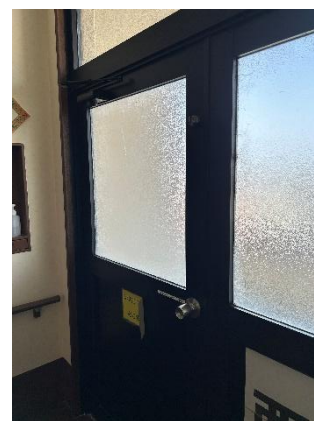
〈鍵修理中非常口〉
