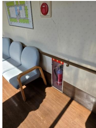
〈消火器前の椅子〉（改善後）
