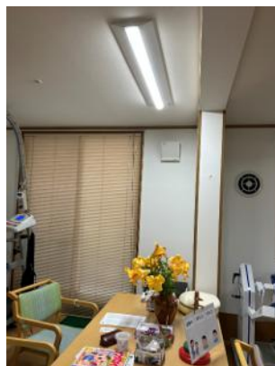
〈デイルームLED照明〉
